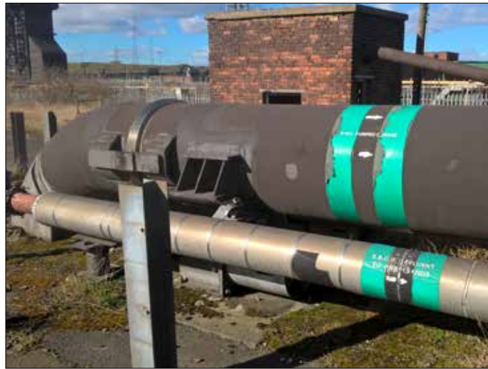
NWL effluent transfer mains
